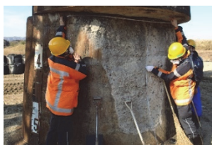
(b) 打継目下部の剥落 図-1 被害状況
