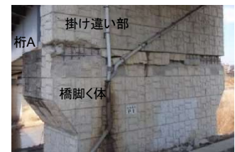
写真-1 橋脚掛け違い部損傷状況
