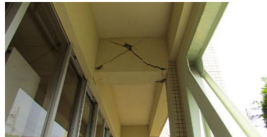
写真-2 せん断破壊した短手方向の梁
