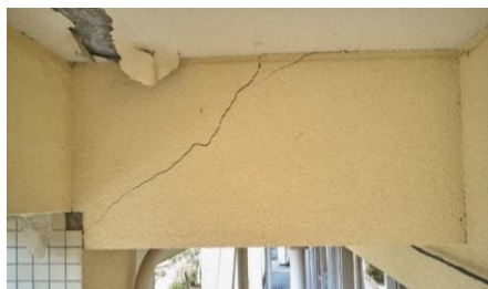
写真-10 FPV静止画撮影による梁の損傷
