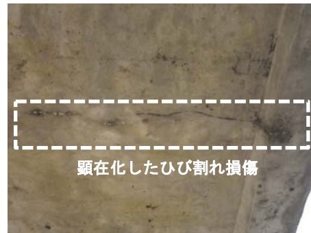
(b) 底版部ひび割れ発達状況
