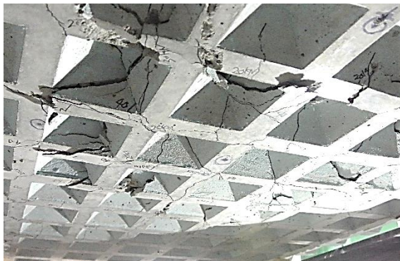
写真-3 A-RC 床版の破壊状況
