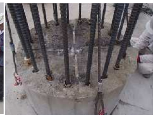
写真 - 22 杭頭破断面
