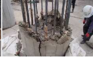
写真 - 24 杭頭破断面 ( 1,200,装薬孔:3本 )
