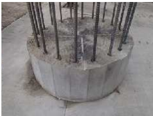
写真 - 20 杭頭破断面
