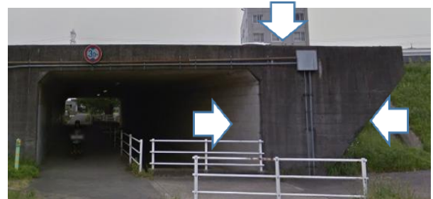
写真-1 対象構造物（矢印は試験箇所、左から「側面内側」、「上面外側」、「側面外側」）
