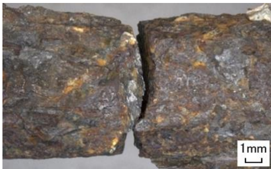
写真-4 材齢 50 年 PC 鋼棒破断部 (CL4.0)
