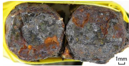
写真-5 材齢 50 年 PC 鋼棒破断面 (CL4.0)
