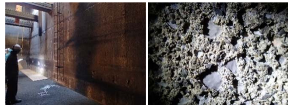
(a) 全体図 (b) 壁面の劣化の様子
