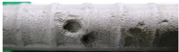
写真-8 EP筋の素地に発生した孔食状況
