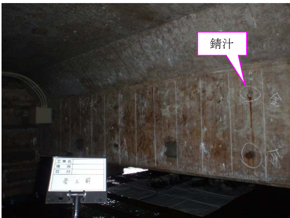
写真-2 RC はりの劣化状況
