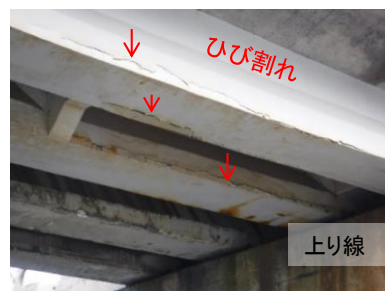
図-14 上り線外観ひび割れ状況
