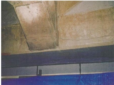
図-4 主桁のひび割れ(橋軸方向)
