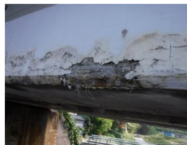
図-13 下り線外観劣化状況
