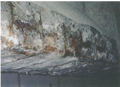
図-5 はつり後の鉄筋腐食状況
