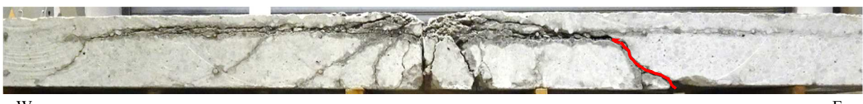
写真-1 切断面（供試体 N）
