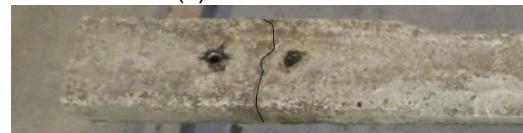
(b) 曲げひび割れ
