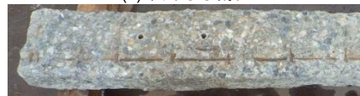
(c) PC 鋼より線の露出
