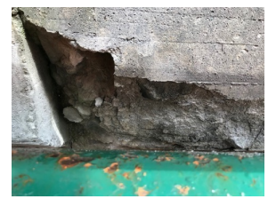
写真-4 ジョイント部の劣化
