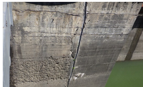
写真-5 スケーリングの状況
