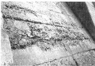
写真-1 スケーリングの状況
