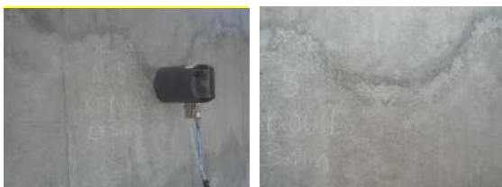
写真-17 天端より680mm 縞模様箇所での透気試験
