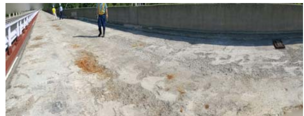
写真-1 舗装開削後の土砂化が進行した事例
