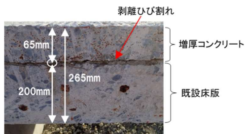
(b) 剥離ひび割れの発生箇所
