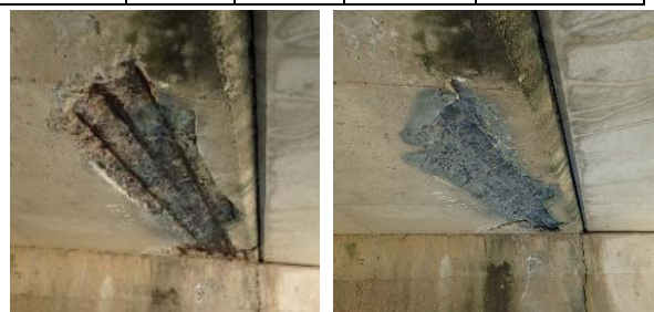
(a) 劣化時の状況
