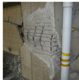
図-2 対象柱被害状況
