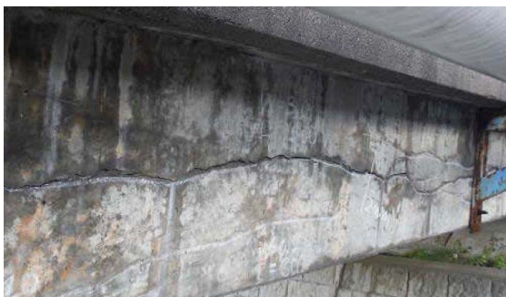
写真-1 PC 中空桁に生じた軸方向ひび割れ
