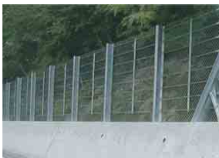
写真-1 従来型落石防護柵の一例
