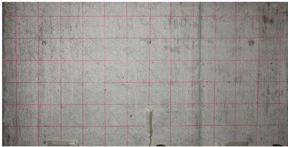
図-12 +1/200 部材角の時のひび割れ状況
