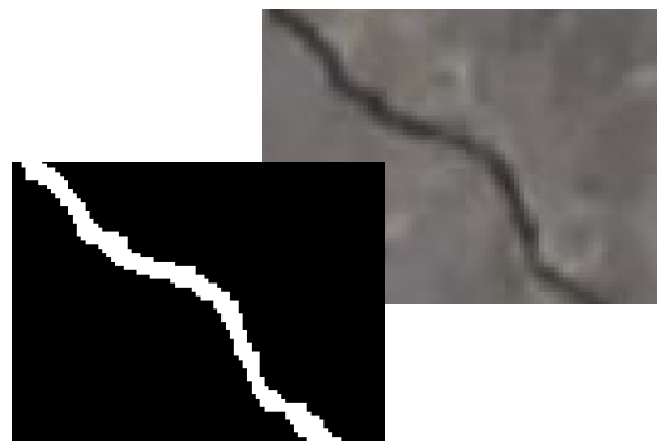
図-16 曖昧なひび割れ領域境界による二値化誤差例
