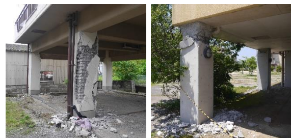
写真-1 大地震で損傷したピロティ RC 建物の例 7)
