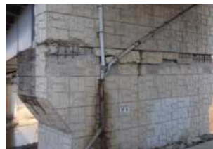
写真-1 橋脚掛け違い部 損傷事例
