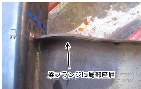
(a) 梁フランジの局部座屈 (梁貫通形式)
