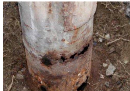
図-1 地際部の腐食事例 1)
