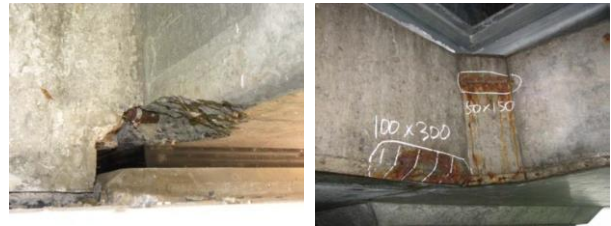
写真-2 データ d での C 判定の鉄筋露出の写真
