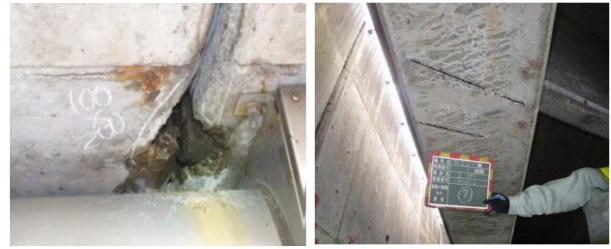
写真-1 データ b での B 判定の鉄筋露出の写真
