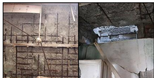
写真-8 31号棟 最上階の劣化例
