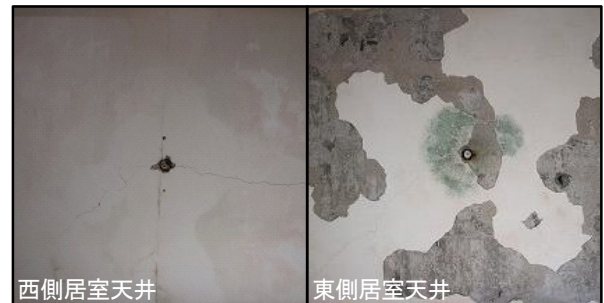
写真-6 東側居室天井と西側居室天井の比較
