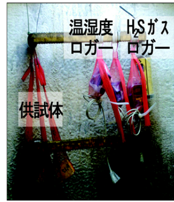
写真-1 マンホール内への各種センサー設置例
