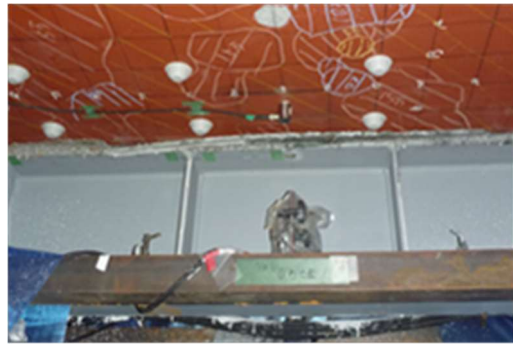
写真-3 PL-6 中央横桁上面シール材のはみ出し
