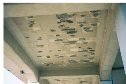
図-2 中間スラブにおけるはく落事例
