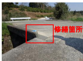
写真-1 予備試験に用いた橋梁および修繕箇所（横田5号橋の地覆コンクリート）
