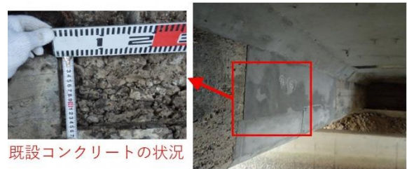
写真-6 既設コンクリートの豆板部に水湿を実践したが水量過多が生じた事例（業者施工）
