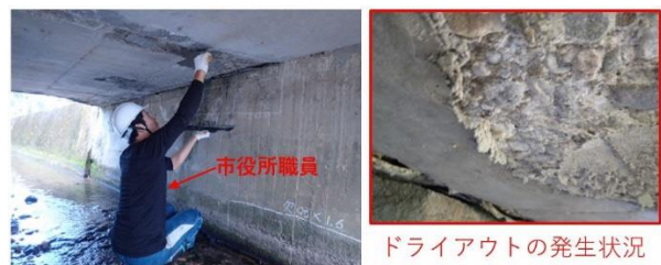
写真-7 豆板部の断面修復で生じたドライアウト事例（直営施工）
