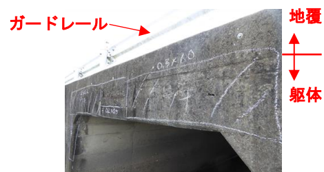
写真-2 156-4号橋の定期点検時の損傷状況
