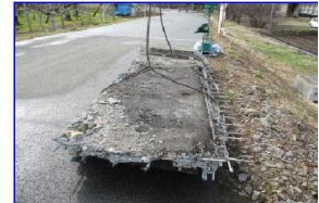
(2) 床版の損傷状況
