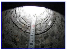
(1) 水平ひび割れの発生
