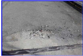
(2) 橋面の損傷状況
