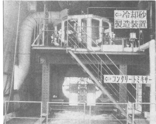
写真-1 冷却砂製造装置
