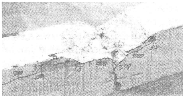
写真-1 コンクリートの剥離部
