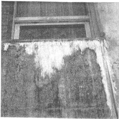
写真-3 窓下壁面のエフロ
