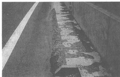
写真-2 縁石コンクリートの損傷例 縁石のコンクリートが脆弱化しており、内部の鉄筋が露出している様子が解る。
