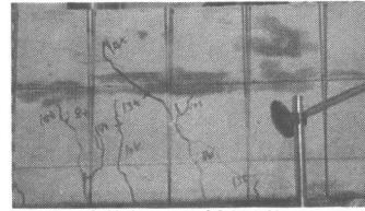
A 側面のひび割れ状況
