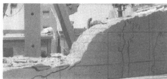
B 内部のひび割れの様子
