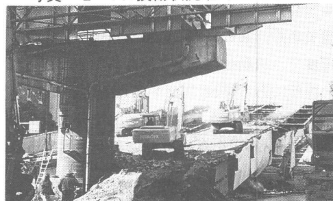
写真-3 P40損傷状況(Cランク)
