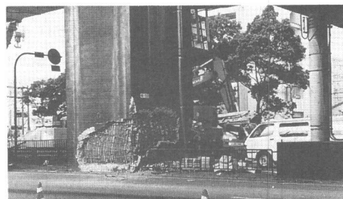
写真-2 P39損傷状況(Bランク)
