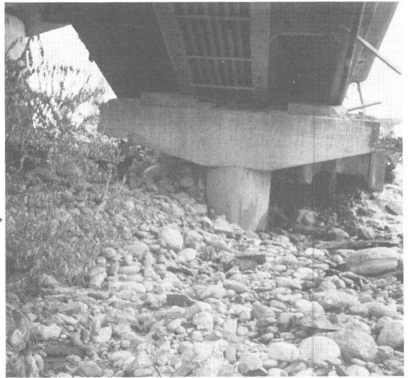
写真-2 B4橋脚損傷状況
