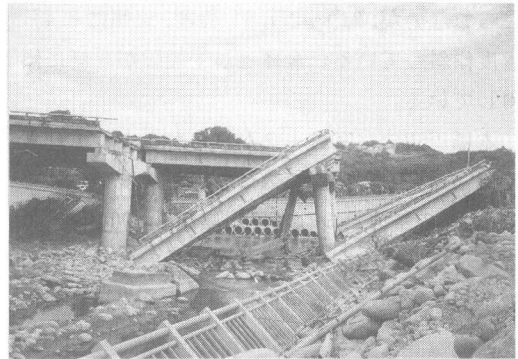
写真-2 石園橋の被害状況
