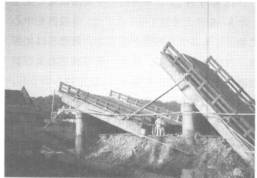
写真-1 一江橋落橋状況
