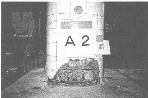
写真-2 APC破壊状況
