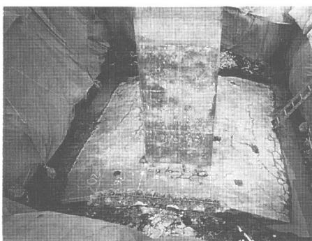
写真-2 フーチングの損傷状況 (ひび割れ, 鉄筋の破断)
