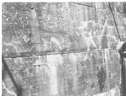
写真-3 ダム堤体の損傷状況 (ひび割れ, 剥離・剥落)
