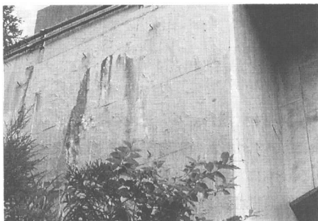
写真-1 橋台の損傷状況 (塗膜の再劣化, 錆汁)
