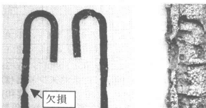
(左: スターラップ 右: 引張鉄筋) 写真-4 鉄筋の腐食状況
