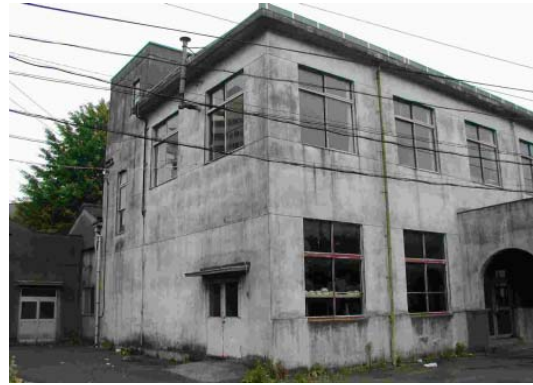
写真-7 庁舎外壁劣化状況
