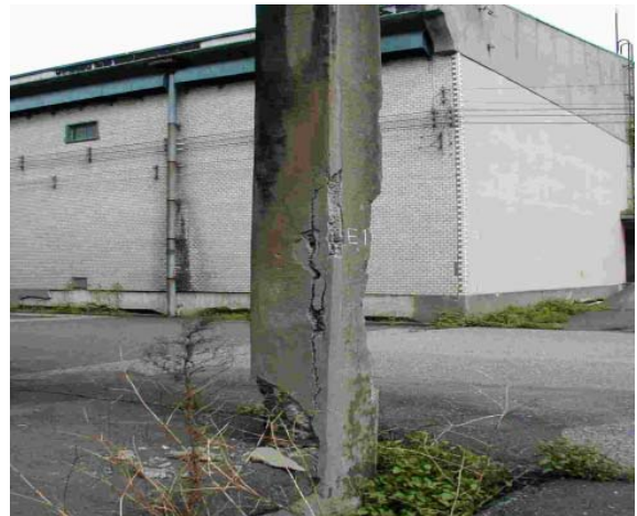
写真-3 柱のひび割れ
