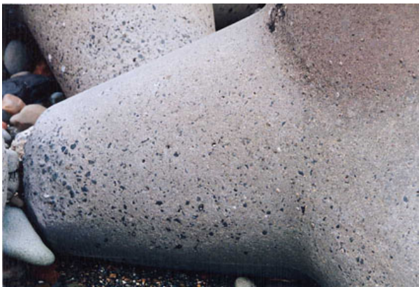
写真—2 消波ブロック脚部磨耗状況 (F-70-A)
