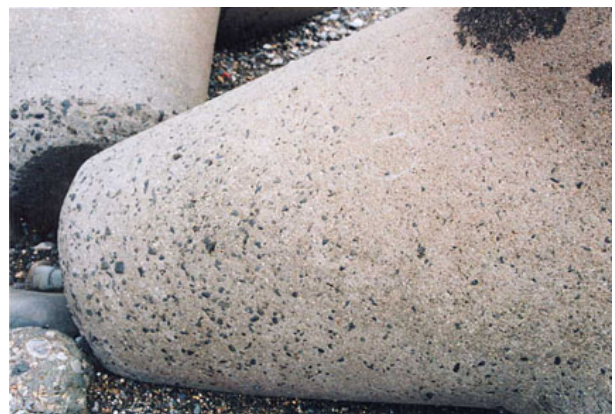
写真—3 消波ブロック脚部磨耗状況 (F-55-A)
