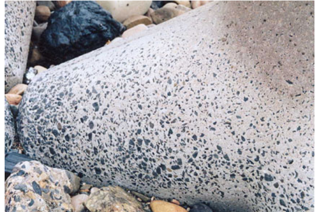
写真—4 消波ブロック脚部磨耗状況 (S21)
