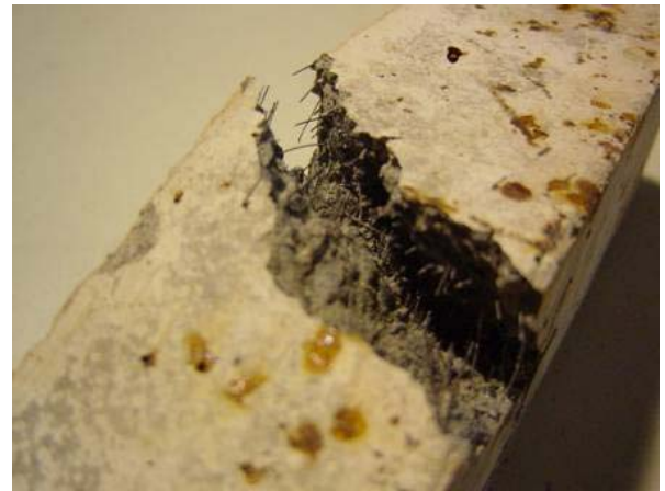
写真-1 SFRC 供試体表面の鋼繊維の状況(促進腐食試験 10 サイクル後, Cl^- = 13kg/m^3 )
