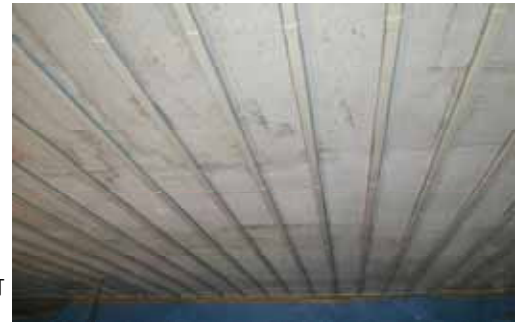
写真 - 1 外付線状陽極方式の設置例
