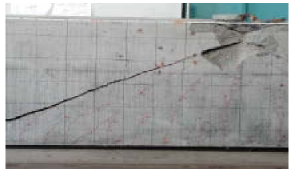
写真-2 PC はりのひび割れ状況
